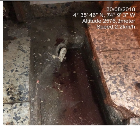
Foto 8. Sangre en cuneta y sifón sellado.
